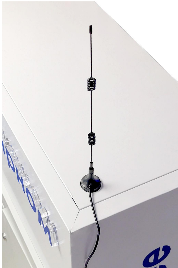
Рисунок 1 – Пример установки антенны на магнитном основании, установка на металлический распределительный шкаф с установленными внутри счетчиками
