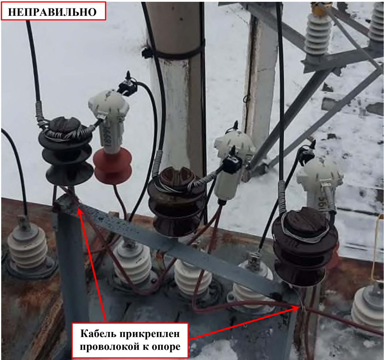
Рис. 20 – Пример неправильного расположения кабелей ВПУ.
